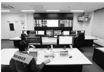
⑧ 消防通信指令施設整備事業 消防本部の通信指令台を更新しました
