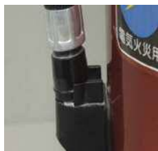
× 消火薬剤の漏れ
