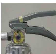
× 安全栓の脱落
