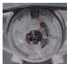
× 指示圧力計の損傷
