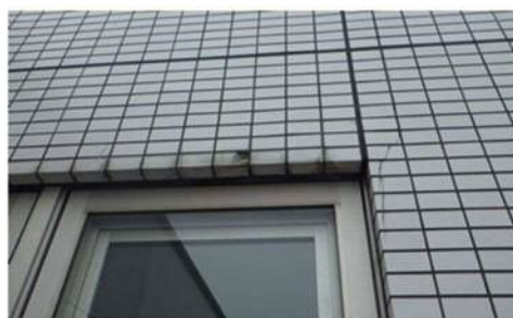
外壁タイルひび割れ
