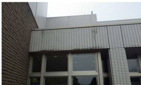
外壁タイルひび割れ
