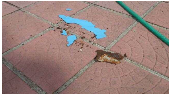
落下した塗装1
