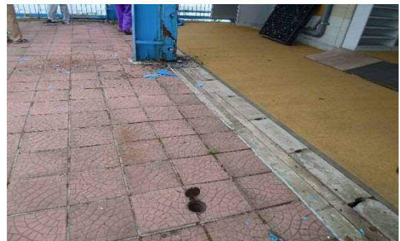
落下した塗装2
