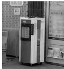
市役所1Fに設置されたスポットクーラー
