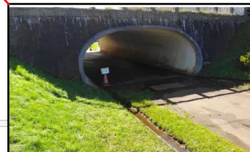
老朽化及び水捌けの悪いトンネル
