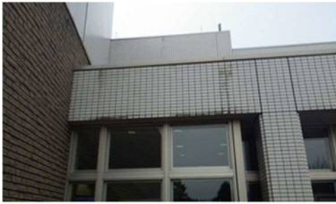
外壁タイルひび割れ
