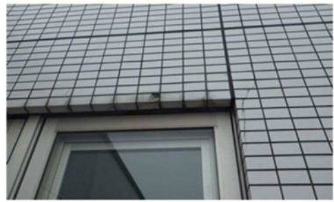
外壁タイルひび割れ
