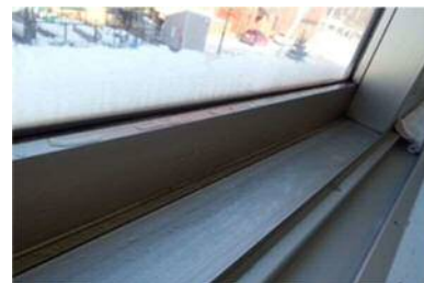
窓サッシの内側結露
