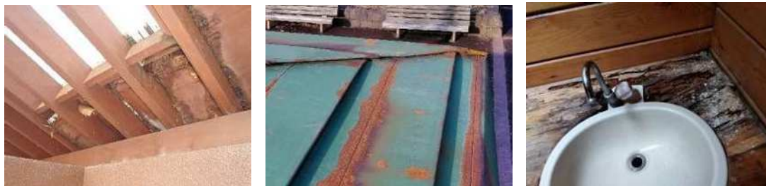
資料9 トイレの老朽化状況
