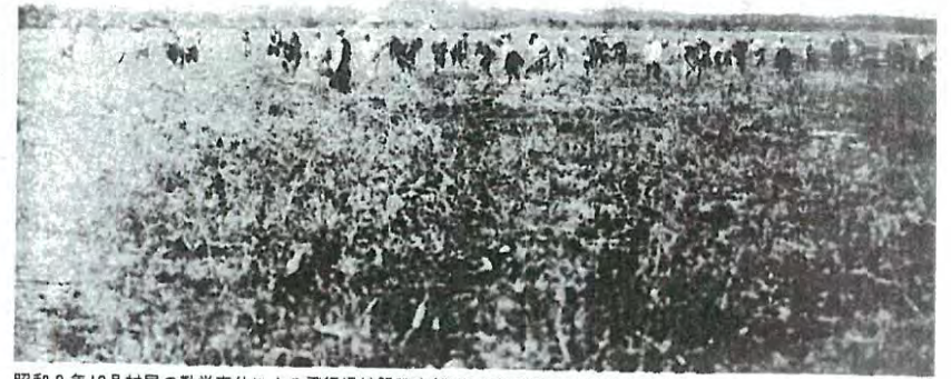
昭和9年10月村民の勤勞奉仕による飛行場拡張工事(昭和10年発行三村銘鑑より)
