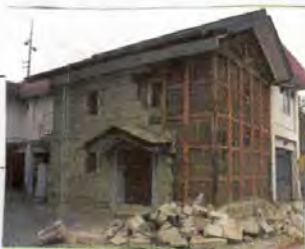
震度7で石づくりの壁がくずれた感。
