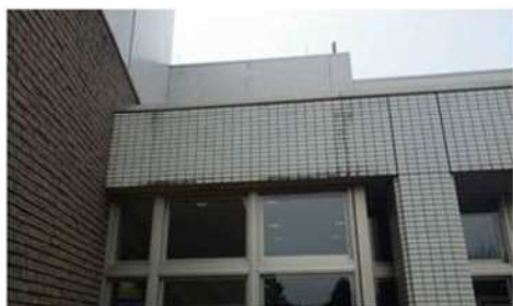
外壁タイルひび割れ
