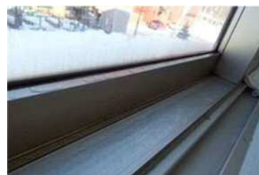
窓サッシの内側結露
