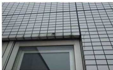
外壁タイルひび割れ
