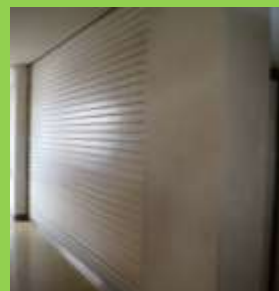
キ 防火シャッター
