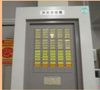
ウ 自動火災報知せつび(受信)
