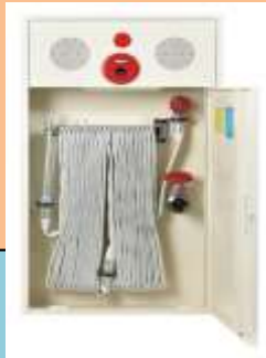
エ 火災報知器(発信)
