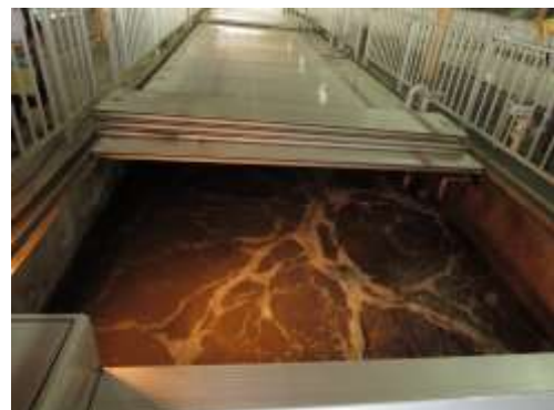
カ エアレーションタンク
