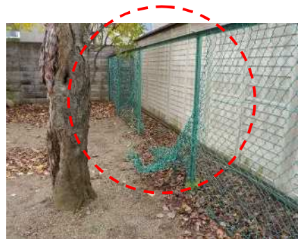
●金属フェンスの変形、破損
