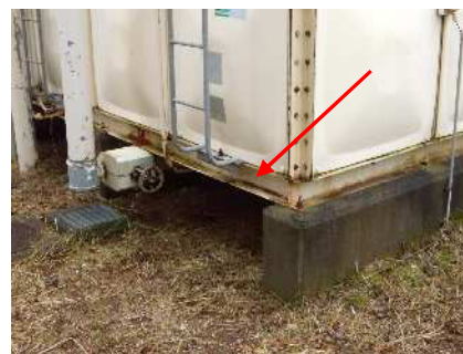
●受水槽架台の腐食
