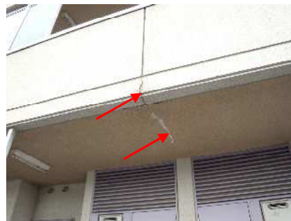
●軒裏のひび割れ
