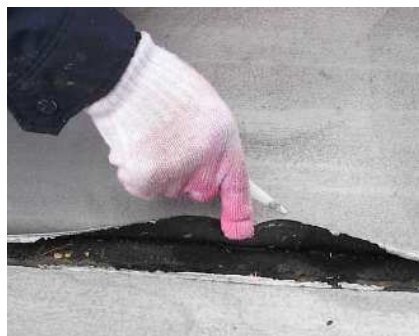
● シート接合部のはく離（平面部）*2
