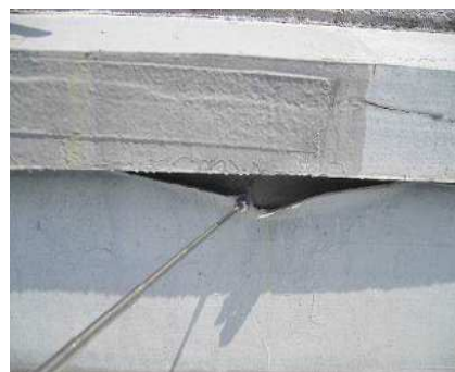
●立上り周辺部のはく離*1
