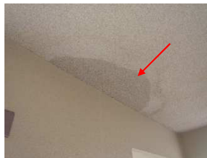
●天井の水染み（雨漏り跡）
