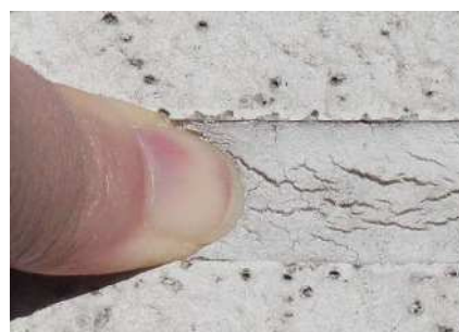
●指圧による亀裂の深さの確認 (写真は軽微な亀裂)
