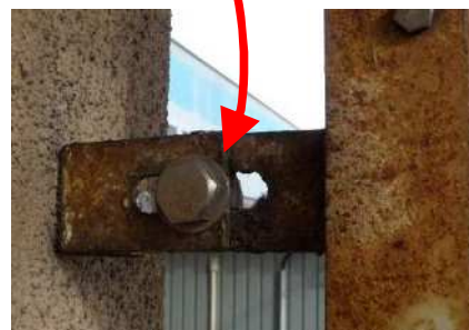
● 隔て板の固定部分のさび
