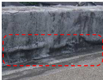
●立上り部の浮き、たるみ
