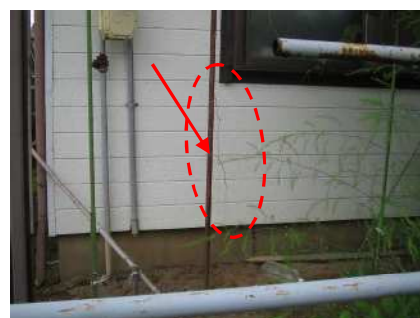
●窯業系サイディングのひび割れ
