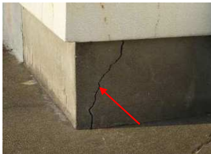
●立上り部分のひび割れ*2
