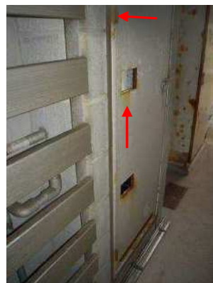
●メーターボックス扉の錆
