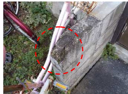
●ブロック塀の破損
