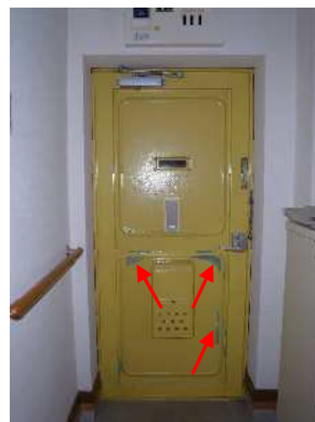
●住戸玄関ドアの塗装の剥離
