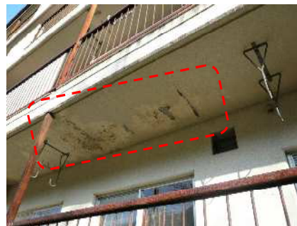
●バルコニー片持ちスラブ下面の仕上げ材のはがれ、鉄筋の露出
