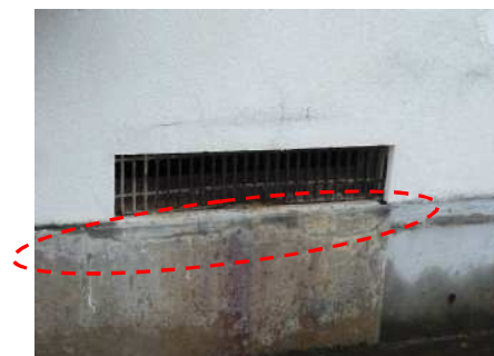
●基礎外周部のひび割れ
