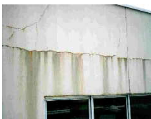
●外壁上部の外周部のひび割れ*2
