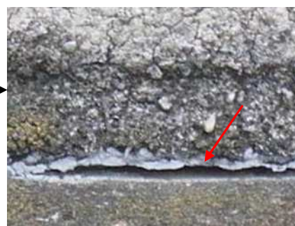
●シーリング材のはく離
