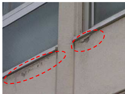
●仕上げ材の浮き、はく落
