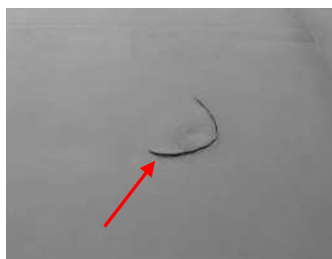
● 防水層の破断、損傷*2 (固定金具付近の破断)
