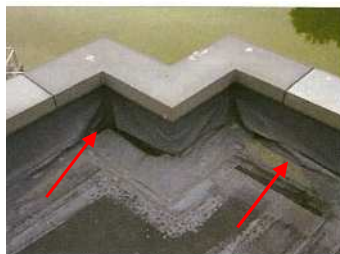
● 立上り部の浮き、たるみ
