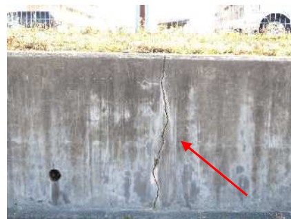
● 擁壁のひび割れ
