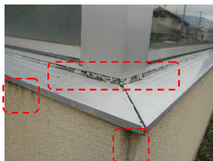
●シーリングの欠損、水切り下部の汚れ
