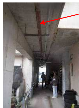
●横引き管の腐食（さび）
