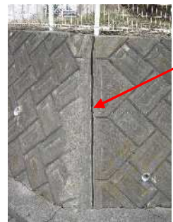
●間知ブロックのコーナー部亀裂
