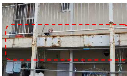
●支柱のさび、バルコニー先端部のひび割れ
