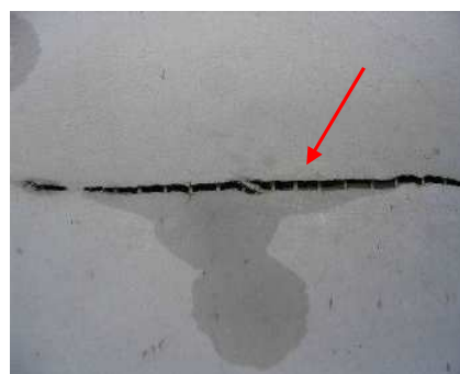
●接合部の破断・損傷*1
