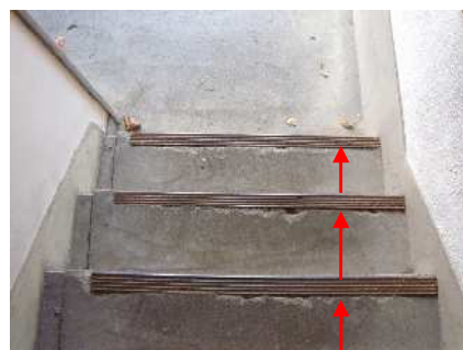
●ノンスリップの腐食（さび）、踏面コンクリートの欠損
