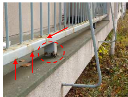
●バルコニー手すりの腐食（さび）
