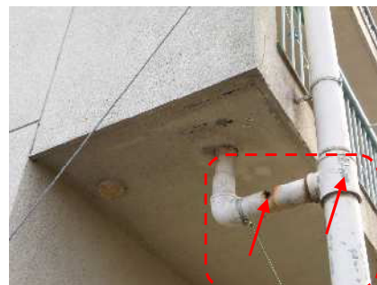
●雨樋の劣化、ひび割れ、塗装の剥がれ
