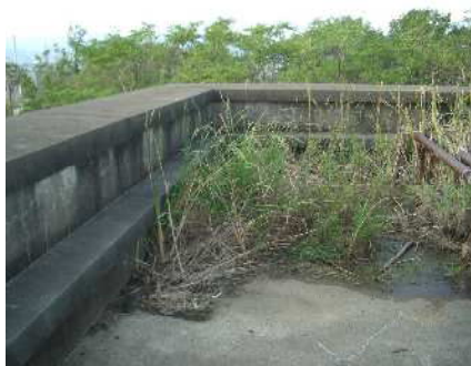
●植物の繁茂*2 防水層を損傷させる場合があるため無理に 抜かない
