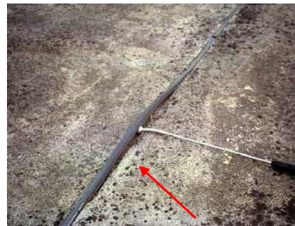
●伸縮調整目地の目地材の飛び出し*2
