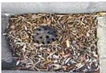
●ドレンまわりに枯葉等が堆積している場合は取除く*1
