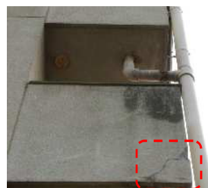
●バルコニー腰壁のひび割れ、欠損
