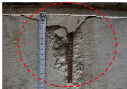
●コンクリート部分のはく落（欠損）、鉄筋の露出
