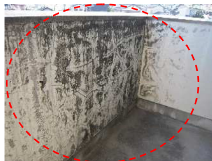
●踊り場腰壁の塗装の剥がれ
