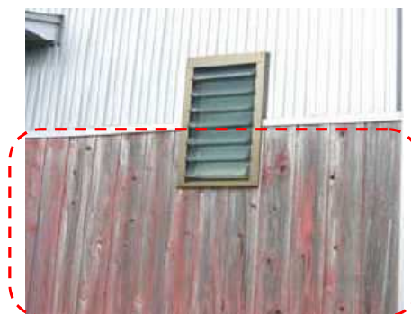
●外壁の木部塗装劣化
