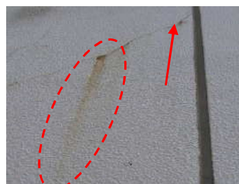
●ひび割れからの錆汚れ
