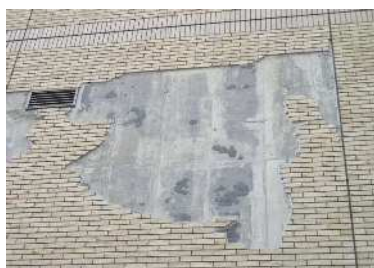
●タイルの剥落
