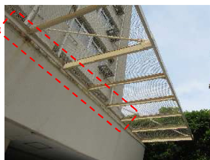
●落下防護底の錆
