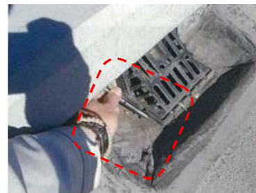
●ドレン接合部のはく離（観察状況）*1
