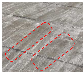
●表面の砂が落ちている*2
