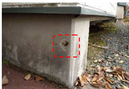
●基礎の鉄筋の露出
