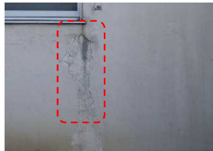
●塗り仕上げのはがれ
