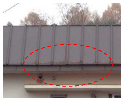
●金属屋根葺き材の腐食（さび）
