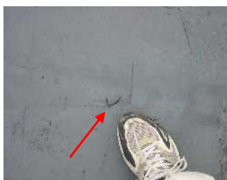
● 防水層の破断、損傷*2 (外的要因による破断)
