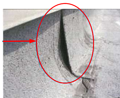
●立上り周辺部のルーフィングのはがれ*2 はく離部分にマイナスドライバーや定規などを差し入れて深さを確認する
