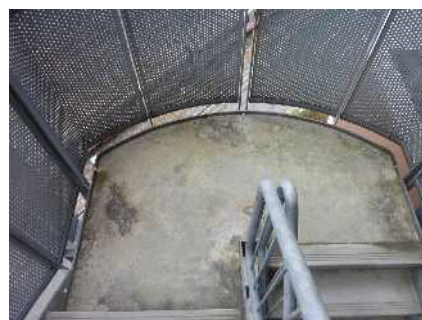
●踊り場の床コンクリートの剥離
