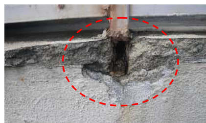
●支柱固定部分の腐食（さび）から発生した鉄筋コンクリートの欠損
