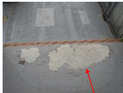
●床仕上げ材のはがれ
