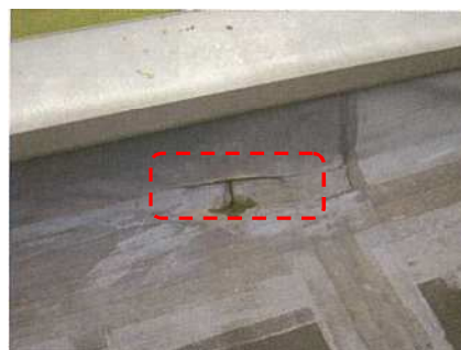
● シート接合部のはく離（立上がり周辺部）*1
