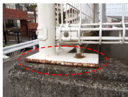
●ゴミ置場支柱柱脚の錆
