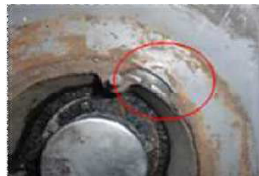
● ドレン接合部のはく離*2
