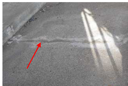
●床スラブのひび割れとエフロレッセンス
