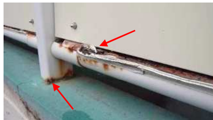
●鋼製手すりの腐食（さび）
