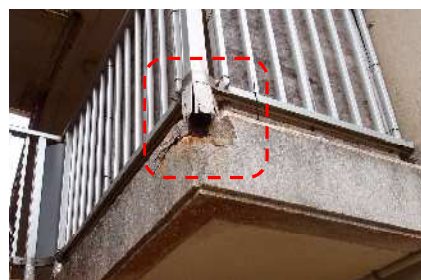
●手すり支柱固定部分の剥落
