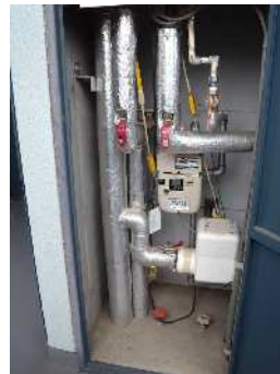
●屋内共用給水管等（PS 内部）
