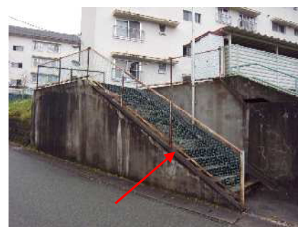
●屋外階段手すりの錆
