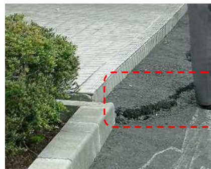
●建築物、工作物周辺の亀裂*4
