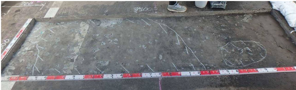
付写真6.3 No.4-1 第4径間-1 (L側) 舗装切削後の床版上面の状況
