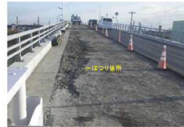
写真 5-1 H30 断面修復前の状況
