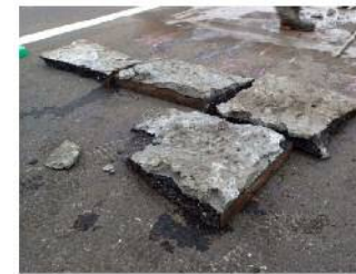
写真 3-6 舗装と断面修復材の付着
