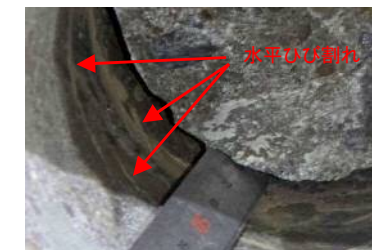
写真 3-27 劣化部の削孔内状況
