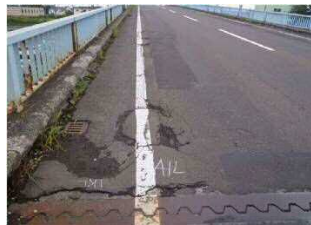
写真① 舗装のひび割れ状況
