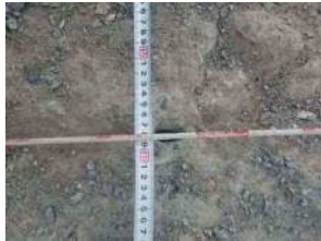
【第3径間：断面修復前の主桁上面状況】
