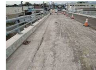
【第2径間：断面修復前の主桁上面状況】
