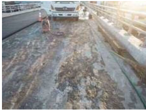
【第1径間：断面修復前の主桁上面状況】
