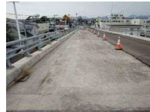
【第3径間：断面修復前の主桁上面状況】
