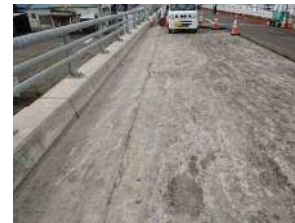
【第1径間：断面修復前の主桁上面状況】
