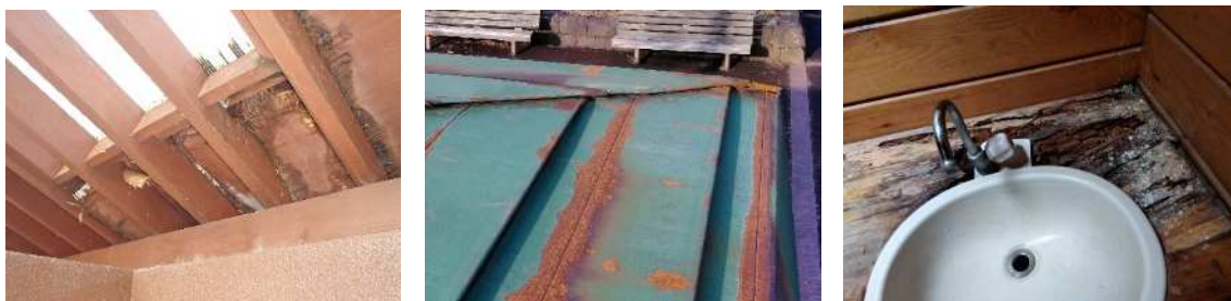
資料9 トイレの老朽化状況
