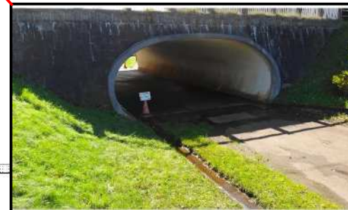
老朽化及び水捌けの悪いトンネル
