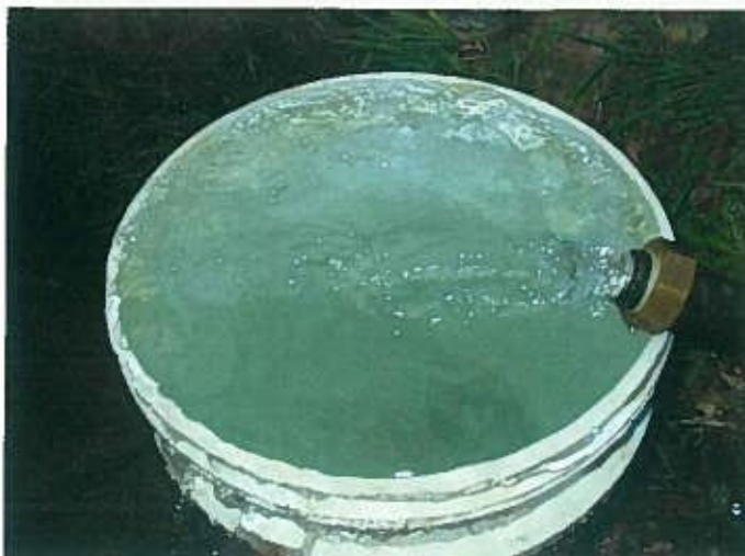
揚水状況 深度7.5m バルブ全開:30L/min 比較的きれいな状態
