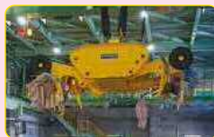
ごみクレーン
