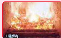
1号炉内 焼却炉
