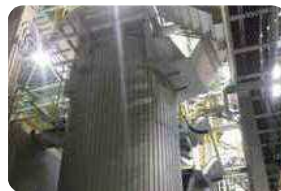
減温塔 焼却炉で発生した排ガスに水を噴霧し、200℃以下の温度まで急速に冷却します。
