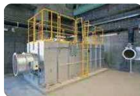
脱臭装置 ごみピット内の臭気対策として悪臭物質を含むガスを処理、無臭にして屋外へ排出します。
