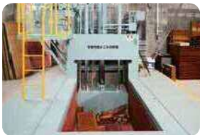
可燃性粗大ごみ切断機 可燃性粗大ごみを燃えやすくするために小さく切断し、ごみピットへ投入します。
