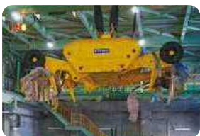
ごみクレーン ごみピットのごみを握搾し均一化した後、焼却炉内にごみを投入します。
