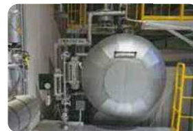
ボイラ ごみ焼却の際に発生する高温の排ガスの熱を蒸気として回収します。
