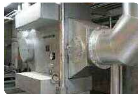
蒸気式空気予熱器 排ガスの熱を利用して焼却炉に送る空気を加熱し、ごみの燃焼を効率化します。
