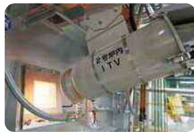
炉内ITV 炉内の状態を撮影し、燃焼状態を監視しています。
