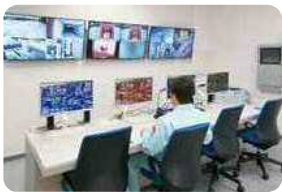
中央制御室 焼却炉など主要設備の運転を自動制御システムにより集中管理しています。
