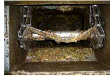
生ごみ破砕分別機の部品が変形し、運転停止
