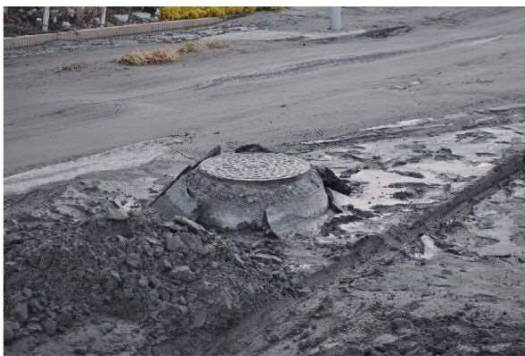
地震によるマンホールの浮き上がり
