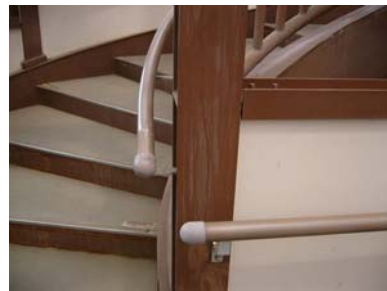
手すり端部が突起状になっています
