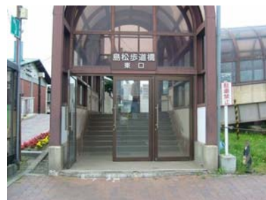
歩道からの出入り口には段差があります
