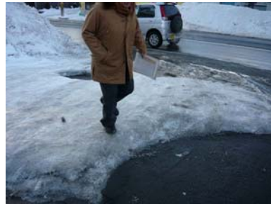
ロードヒーティングとの境界が大きな段差となっています
