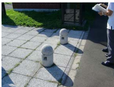
歩道との境界部分に段差が見られます
