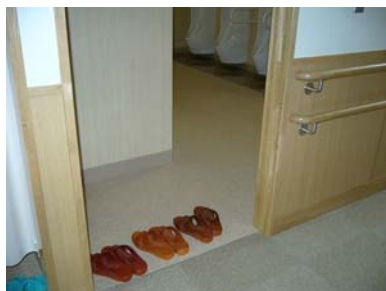
トイレがバリアフリー化されていても、スリッパ等が置かれ、車いすを使用する人の支障になる例が見られます
