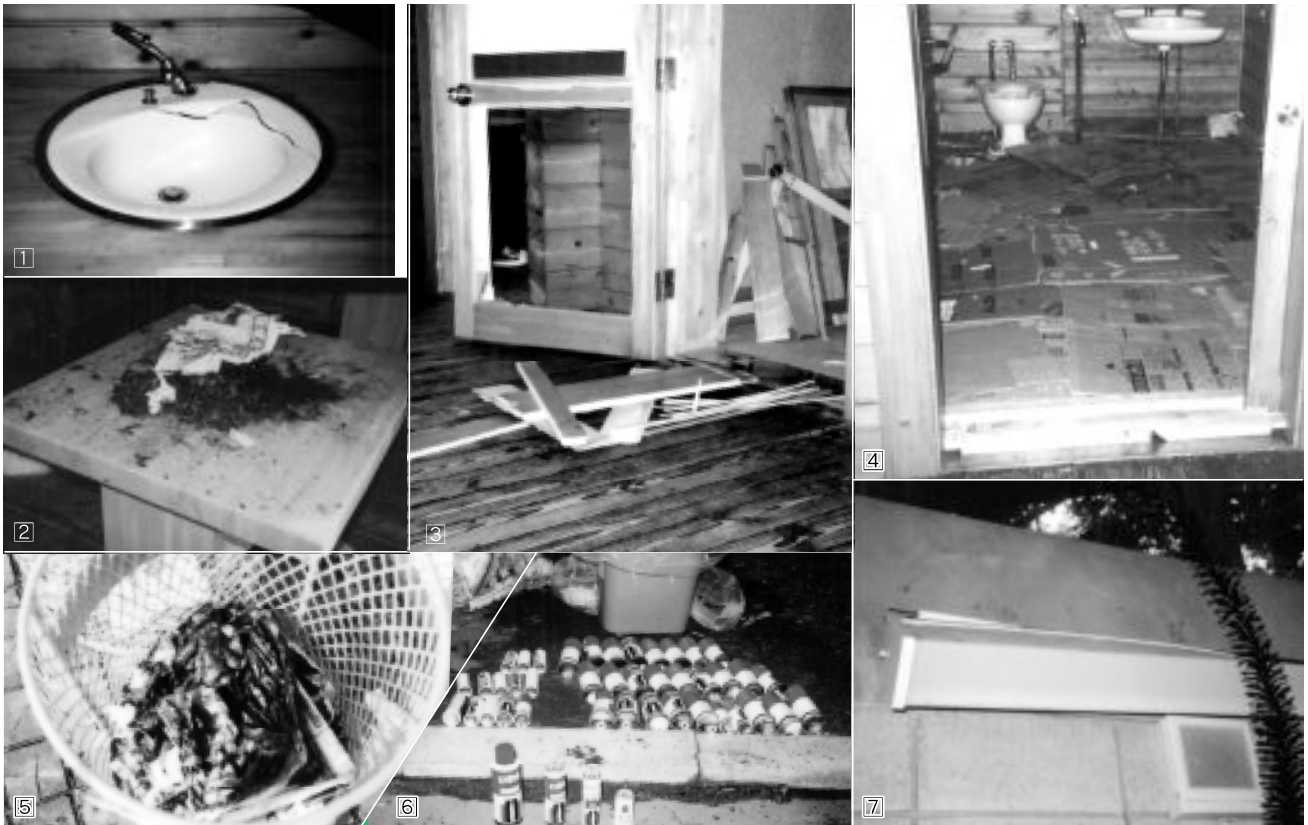
▲①～⑤は『中島公園公衆トイレ』の被害状況 ①手洗い場の陶器3カ所すべてが割られた ②採暖室内にある木製テーブル。他のテーブルにも同様に火がつけられた ③機械室ドア。粉々に壊された ④身体障害者用トイレの内部。ダンボールを敷き、生活していた跡が見られた ⑤外に置いていた、ゴミ箱
