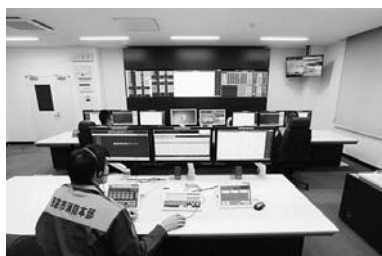
⑧ 消防通信指令施設整備事業 消防本部の通信指令台を更新しました
